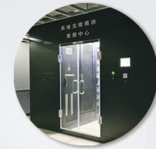
数据中心集成
